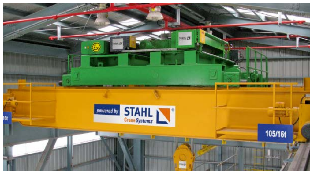
Lanové kladkostroje v nevýbušném provedení s pomocným zdvihem ve dvojitém provedení pomáhají při údržbě kompresorů v zařízení pro zkapalňování vodíku.
